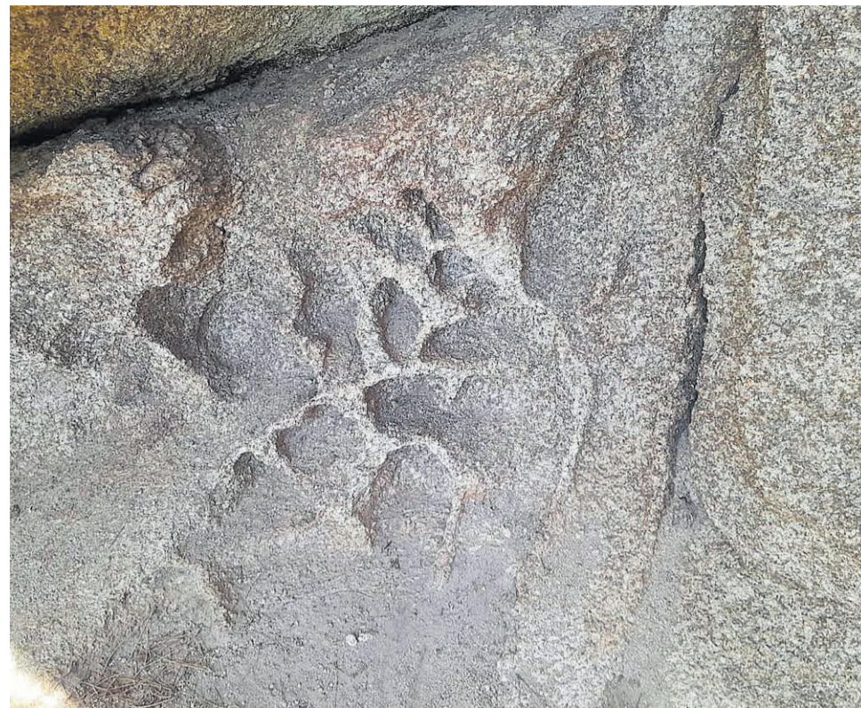
Heridas esculpidas en los muros por la erosión y la propia sal que surcan las paredes de la estancia.
